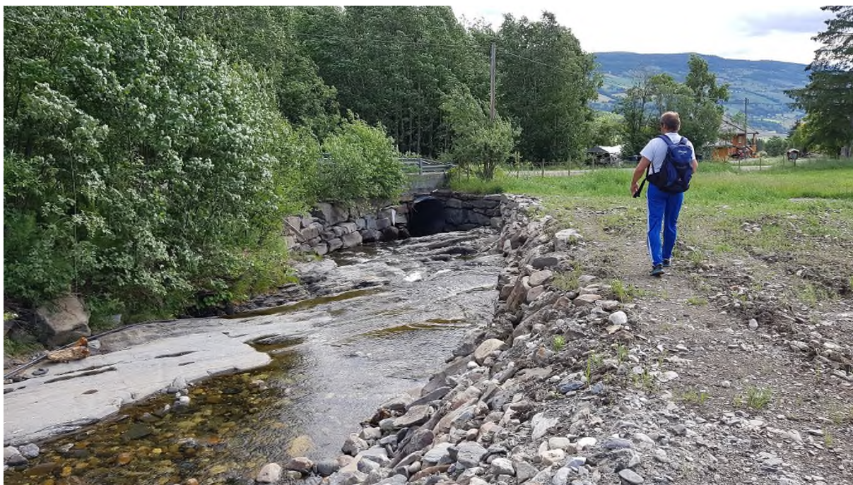
Bilde 61: Innløp vegkrysning Vintervegen sett litt oppstrøms fra
