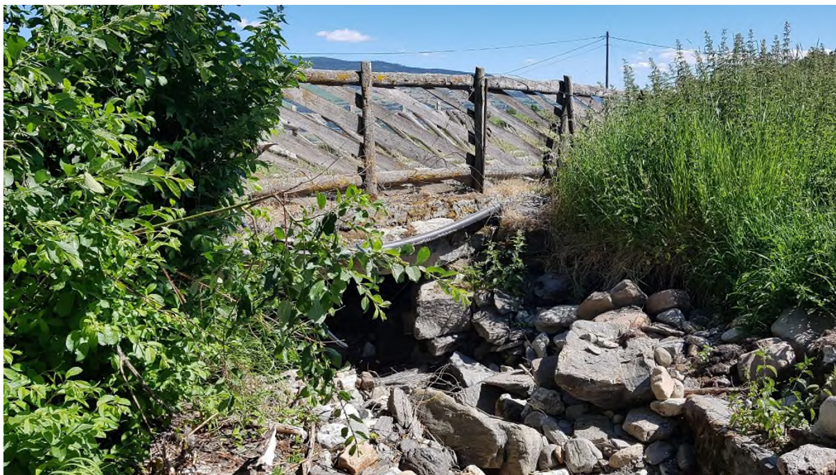
Bilde 82: Innløp vegkrysning gårdsveg oppstrøms Baksidevegen
