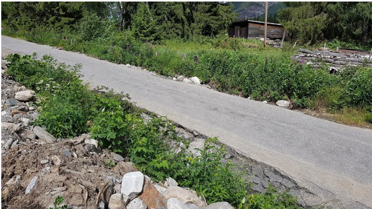
Bilde 54: Erosjonsskader på begge sider av bilvegen Gålåvegen like nedenfor Øvre Nigard Skurdal
