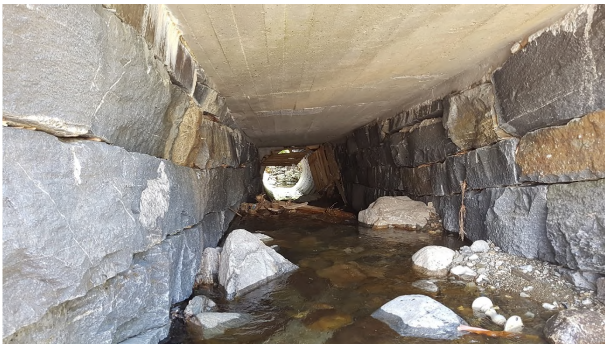
Bilde 28: Kulvert vegkrysning Dålåstigen 467
