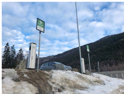
De nye ladestasjonene ved Fron Badeland.
