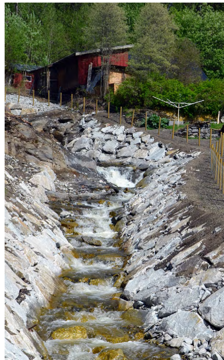
Flomsikring langs husene i Sør-Fron. Foto: NVE
